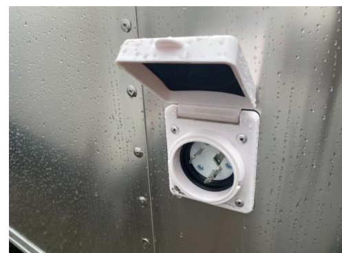
● 外部電源引き込み口
